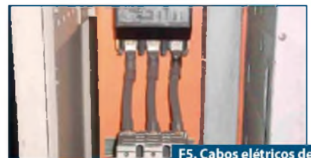
F5. Cabos elétricos de instalação.
