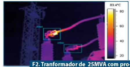
F2. Transformador de 25MVA com problema na conexão de entrada.
