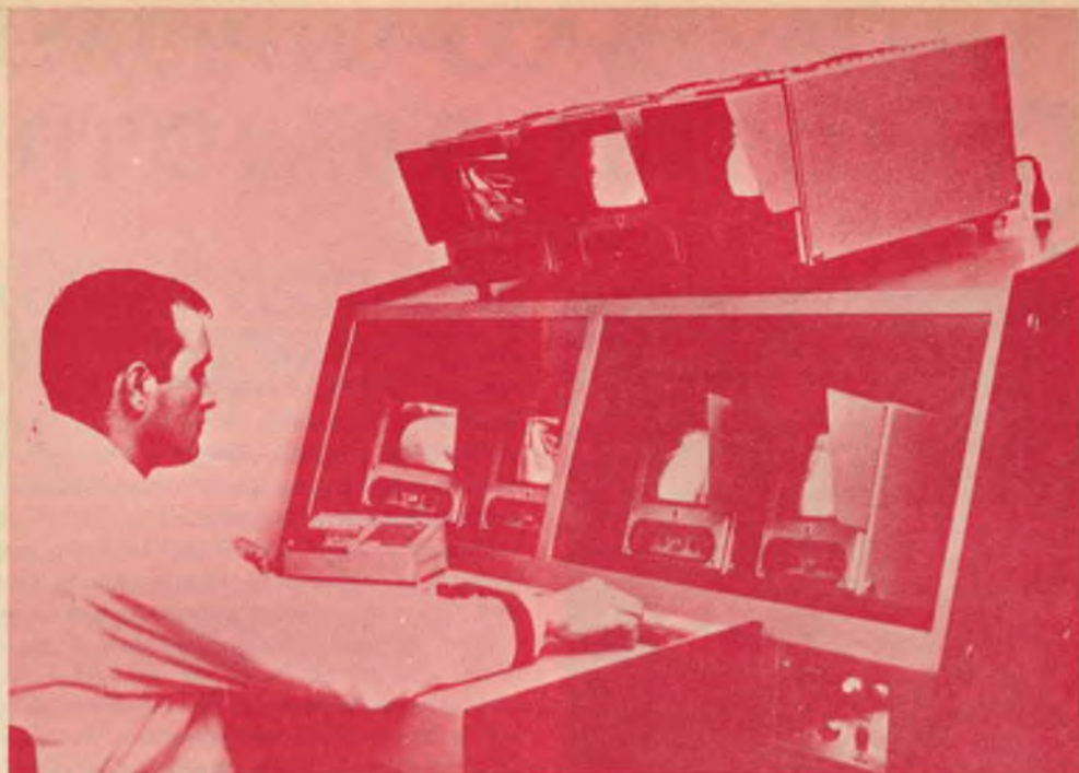
Posto di controllo centrale dell'impianto di televisione a circuito chiuso installato all'autodromo di Monza, tramite il quale è possibile seguire istante per istante lo svolgersi delle competizioni sportive.
