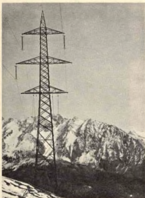
Pala a traliccio usato per il sostegno della linea a 220 kV, Avise-Gran S. Bernardo (SIP).
