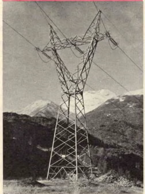
Palo in ferro, a traliccio, tipo a Y della linea a 220 kV Venau-Torino (SIF); nella foto sono visibili due funi di guardia installate sulla sommità.
