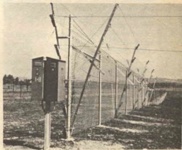
Recinti a capacità salvaguardano un'area esposta. I fili bilanciati elettronicamente possono rivelare una persona alla distanza di un metro anche se si arrampica sulla rete. Il recinto può essere collegato a terra se si ha interesse a proteggere pure il lato verso la strada.
