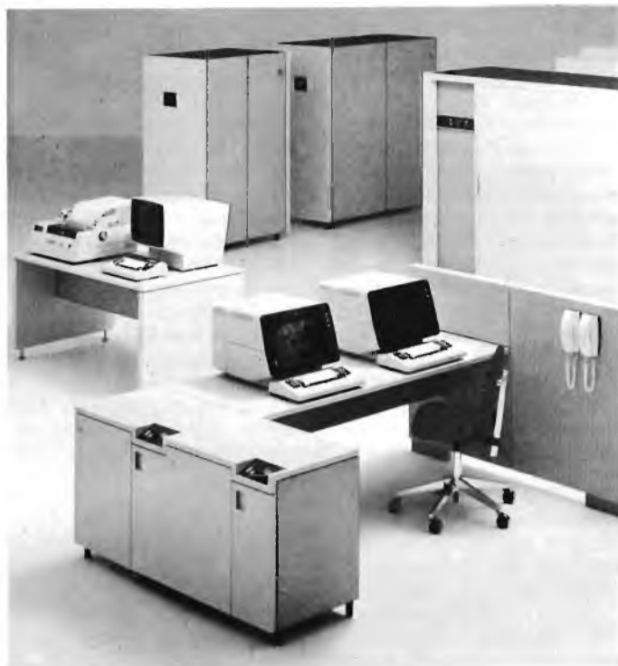
Nella foto, vista di un razionale complesso di elaborazione della IBM Italia, in una sofisticata architettura. Oltre alle unità di raffreddamento, alimentazione, controllo ed elaborazione si notino il banco del terminale video con stampante e il banco per l'operatore con terminale video a colori.
