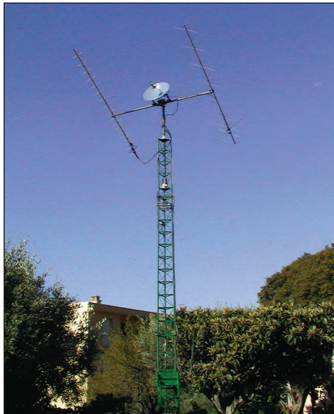
Le pylône de l'auteur
