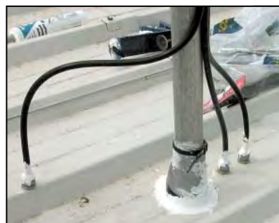
Traversées du mât porteur et des câbles.
