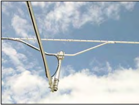
Sur un balancier horizontal sont montés deux bras de déport verticaux, pour les UHF et SHF.
