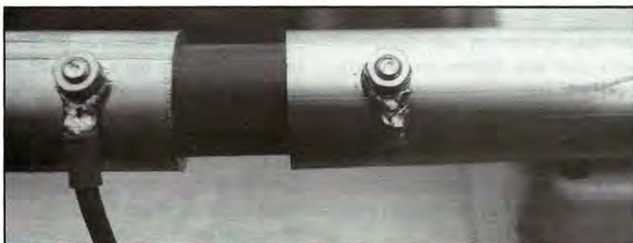
2 Les soudures à revoir d'autant que, manque de chance, l'une était une soudure sèche.
