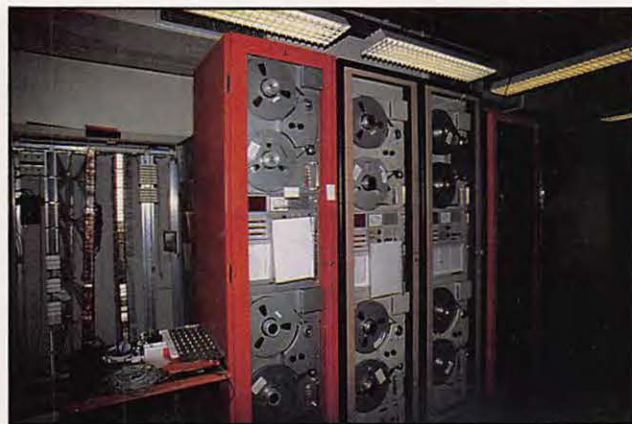
Les baies d'enregistreurs.
