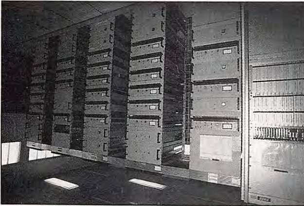
Station radio : les baies d'émission.
