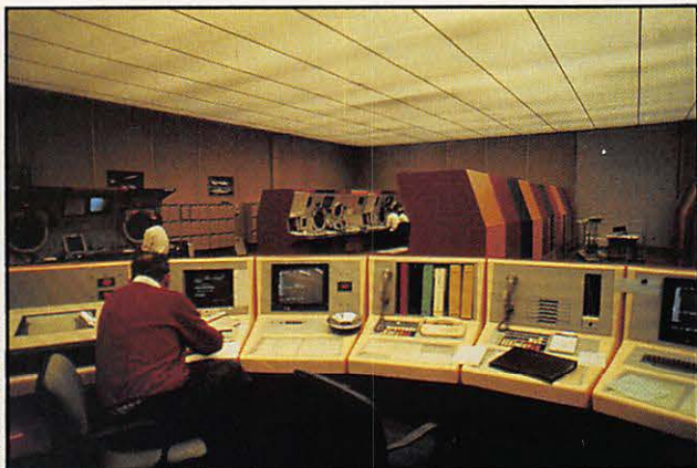
Salle d'exploitation. Au premier plan, la console du superviseur.
