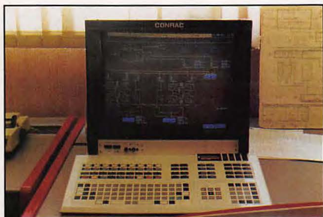
L'automate surveillant la centrale électrique.
