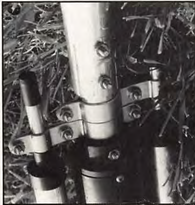
Montage des tiges condensateurs.
