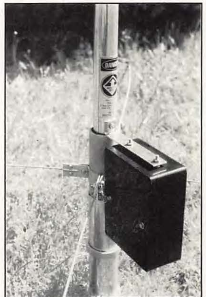
Vue des composants de pied d'antenne.
