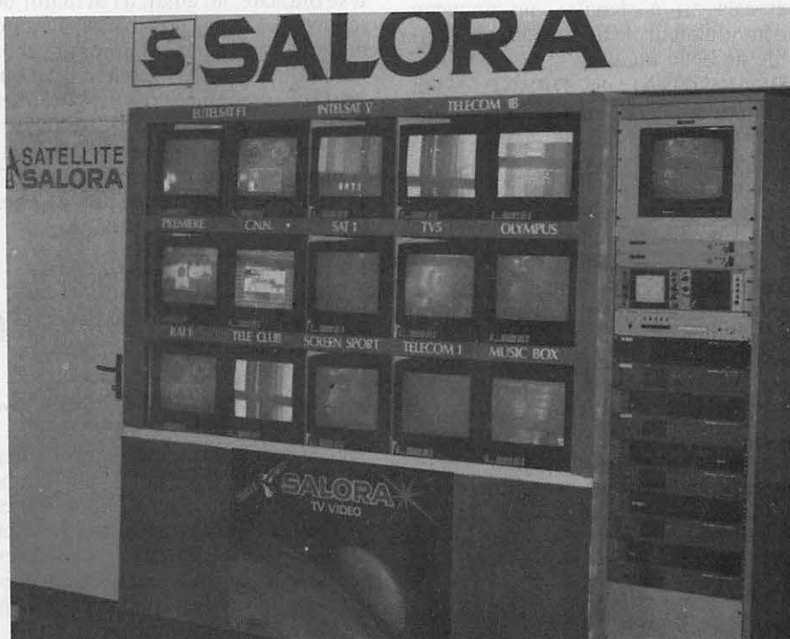
Baie de démonstration SALORA.
