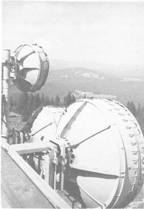
Ci-dessus, un groupe d'antennes paraboliques de faisceaux hertziens. Ils reçoivent les signaux audio-vidéo du centre de production de Genève.
