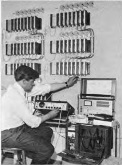
Bild 6. Einpegeln einer Hauptverstärkerstelle nach dem System GGA II in Sicaset-Bauweise. Im Endausbau soll die Anlage etwa 10 000 Wohnungen versorgen (Siemens)
