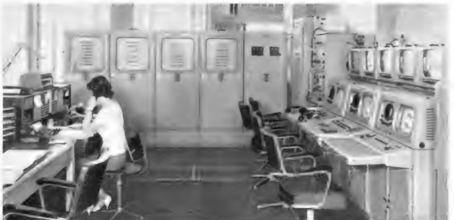
Bild 11. Schalt-, Verteil- und Kontrolleinrichtungen in der Fernseh-Schaltstelle der Deutschen Bundespost in Frankfurt am Main (Fernmeldehochhaus)
