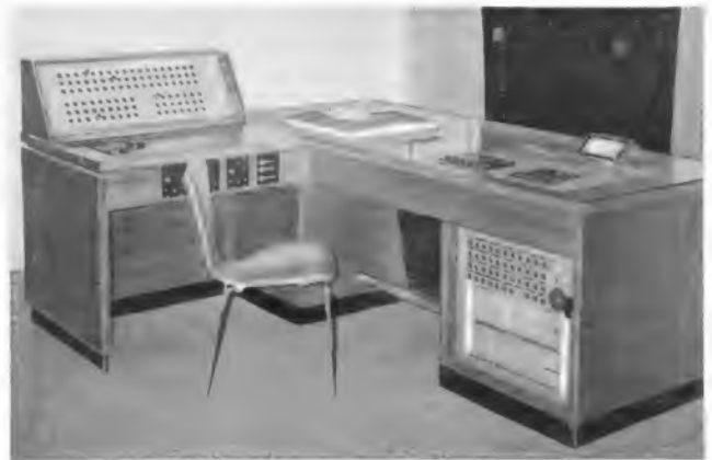
Bild 1. Regietisch der Übertragungsanlage in der Meistersingerhalle Nürnberg
