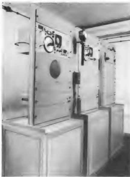
Bild 6. Die Quarzgeneratoren im Quarzkeller sind in schwingungsfreien Gestellen untergebracht. Temperatur- und Feuchtigkeitsfühler steuern die automatische Regelung von Raumtemperatur und Luftfeuchtigkeit
