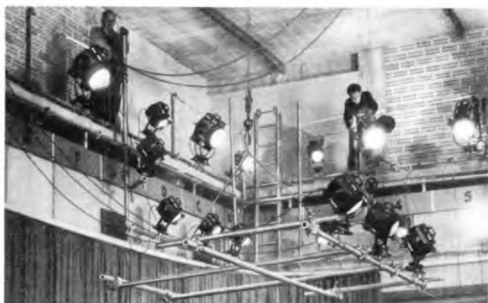
Ein Teil der Studio-Beleuchtungsanlage
