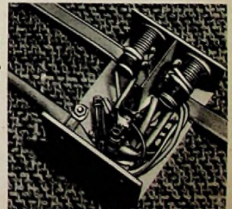
Bild 6. Blick in die Verdrahtung der UKW-Vorstufe. Hinten links: Eingangsdrossel L2; hinten rechts: Ausgangsdrossel L3
