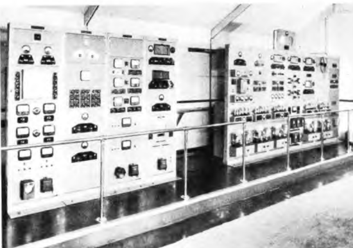
Englische Drahtfunk-Sendeinrichtung zur Übermittlung von Fernseh- und Rundfunkprogrammen (E. M. I. Relays (Hayes Ltd.)). Das linke Gestell enthält den Fernsehsendeteil, während die rechts sichtbare Anlage zur gleichzeitigen Übertragung von fünf Rundfunkkanälen eingerichtet ist.
