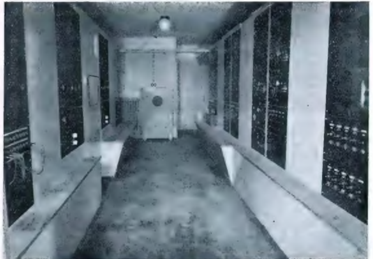
Bild 3. In der Verstärkerzentrale der Telefunken-Lautsprecheranlage des Deutschen Opernhauses in Berlin sind die Verstärker und Zusatz-einrichtungen übersichtlich an den beiden Längsseiten des Raumes angeordnet. Im Hintergrund sieht ein Kontroll-Lautsprecher.
