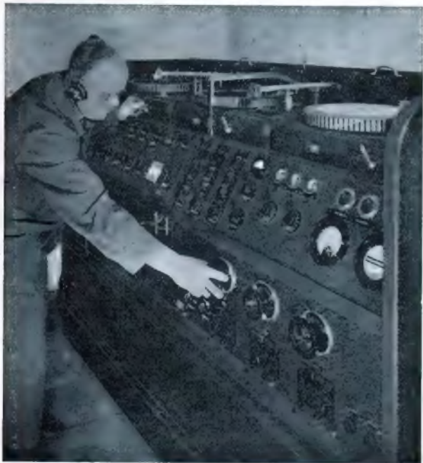
Bild 2. Ein Blick in die Zentrale der Telefunken-Lautsprecheranlage des Prinzregenten-Theaters in München. Drei Plattenspieler auf dem Ober- teil des Zentralenpultes geben dem Inspeizienten die Möglichkeit, die verschiedensten Platten als Geräufchkulisse in die Handlung einzublenden.
