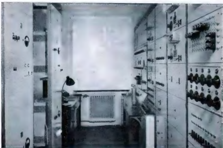
Neben der Hauszentrale im „Haus Elephant“ ist die Gauzentrale des Gaues Thüringen untergebracht. (Werkbilder: Telefunken - 3)
