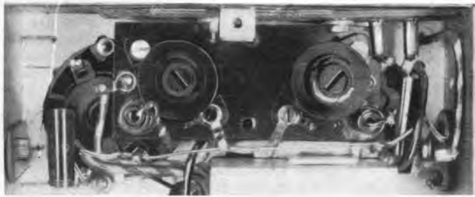
Das ZF-Filter unterhalb des Chassis. Ein Bild, das die Anordnung und Verdrahtung dieses wichtigen Teils des Gerätes besonders deutlich zeigt.
