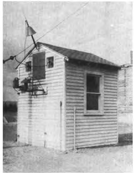
Dieses Häuschen enthält nichts anderes als die Elemente für die Antennenabstimmung eines 100-Kilowatt-Senders
