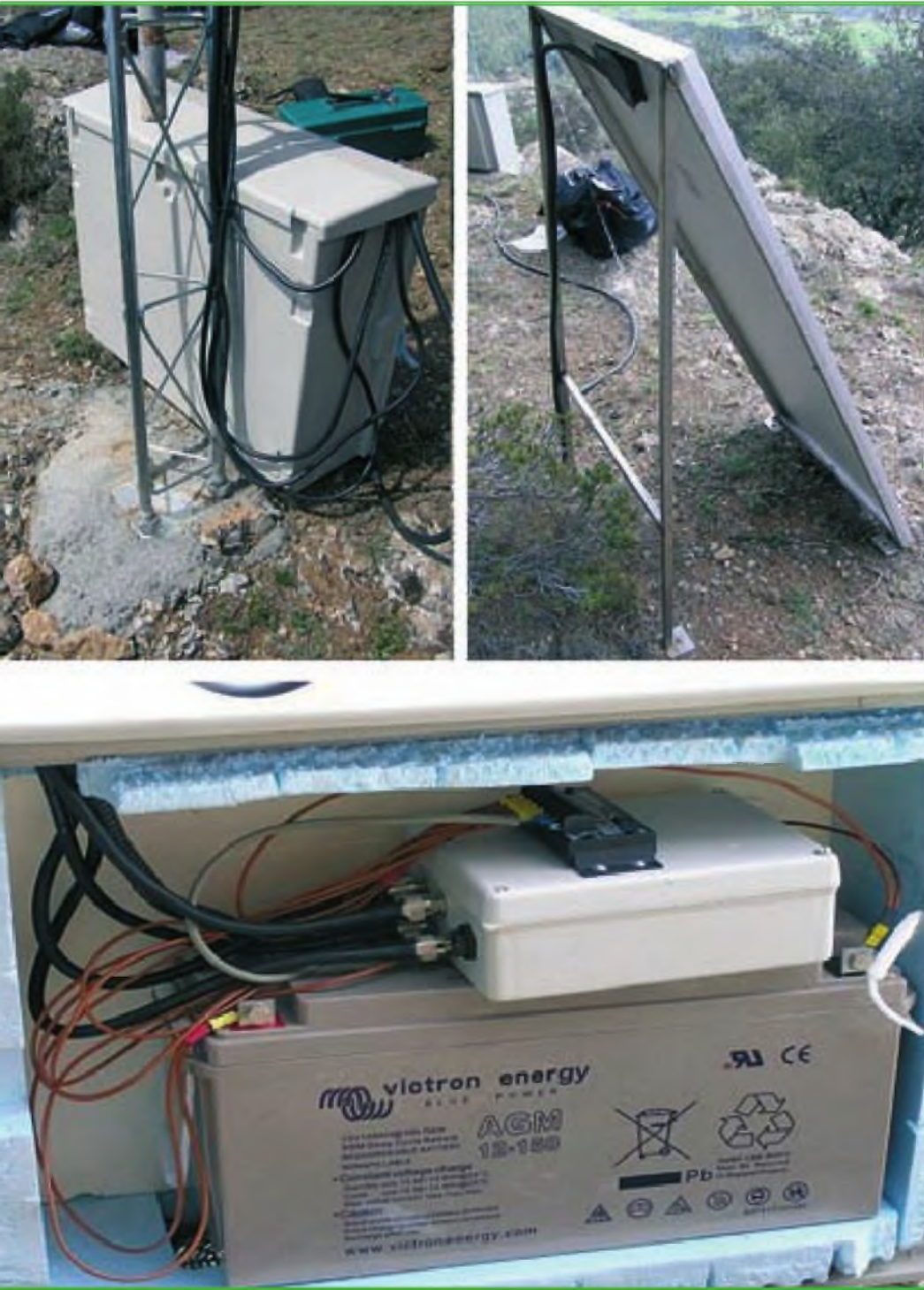
Foto C. La creación de enlaces inalámbricos con tecnologías Wireless o WiMAX, dotados de placas solares y baterías, nos permitirán disponer de autonomía en caso de fallo de suministro eléctrico y ofrecer ciertas garantías en caso de catástrofe.
