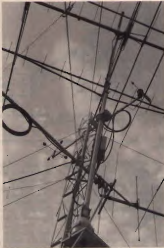
16 Posizionamento del Box-commutatore alla sommità del traliccio".
