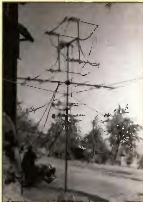
Obr. 30. Antenní systém pro pásma 2 m až 13 cm jako „ozdoba“ hotelu Panorama na Benecku. Kabely vedou do kotelny, kde bylo pracoviště
