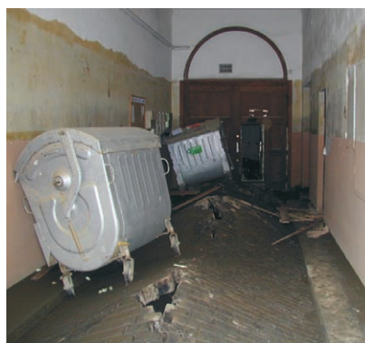
A takto vypadal vjezd do přízemí - je vidět kam sahala voda, a rovněž podlaha nevydržela obrovský tlak vody
