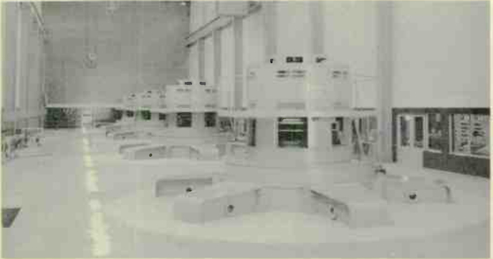
Un aspecto de la sala de generadores de la hidroeléctrica Temascal
