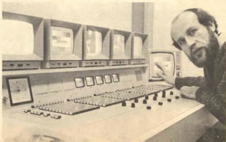
Centrale audiovisiva con distributore elettronico a sbarre incrociate.
