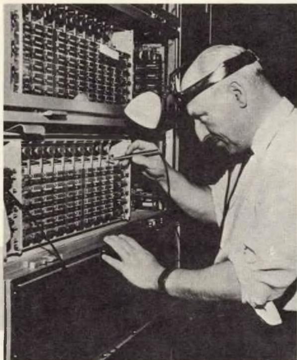
Nella fotografia si vede un ingegnere mentre effettua il collaudo finale su un'apparecchiatura di commutazione del nuovo scambio telefonico di Sydney.
