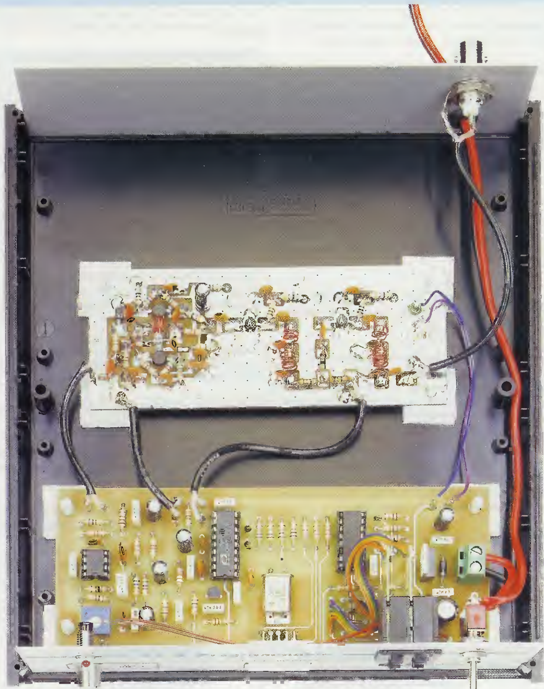
Fig.21 All'interno del mobile plastico utilizzato come contenitore, la scheda del VCO e quella del PLL vanno fissate sul piano del mobile con dei distanziatori plastici provvisti di Base autoadesiva che troverete nel kit. I perni di questi distanziatori plastici andranno infilati nei fori presenti ai quattro angoli di ciascun circuito stampato, andrà quindi tolta da ogni Base la carta che protegge l'adesivo, esercitando una pressione adeguata. In questa foto potete vedere i due Commutatori Binari S1-S2 già fissati, a pressione, sul pannello frontale del mobile. Sulla destra del pannello posteriore potete vedere il connettore BNC dal quale andrà prelevato il segnale RF generato dallo stadio VCO.
