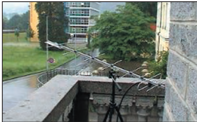
Installation émission de HB9OAB.
