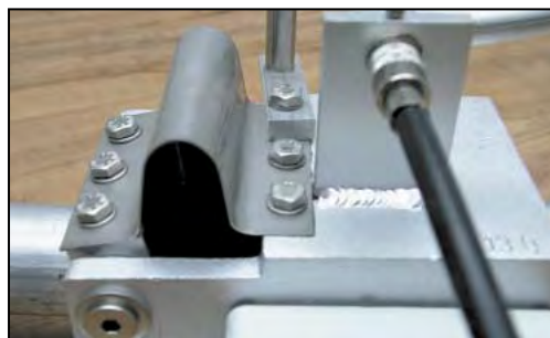
Jonctions mécaniques électriquement soignées.
