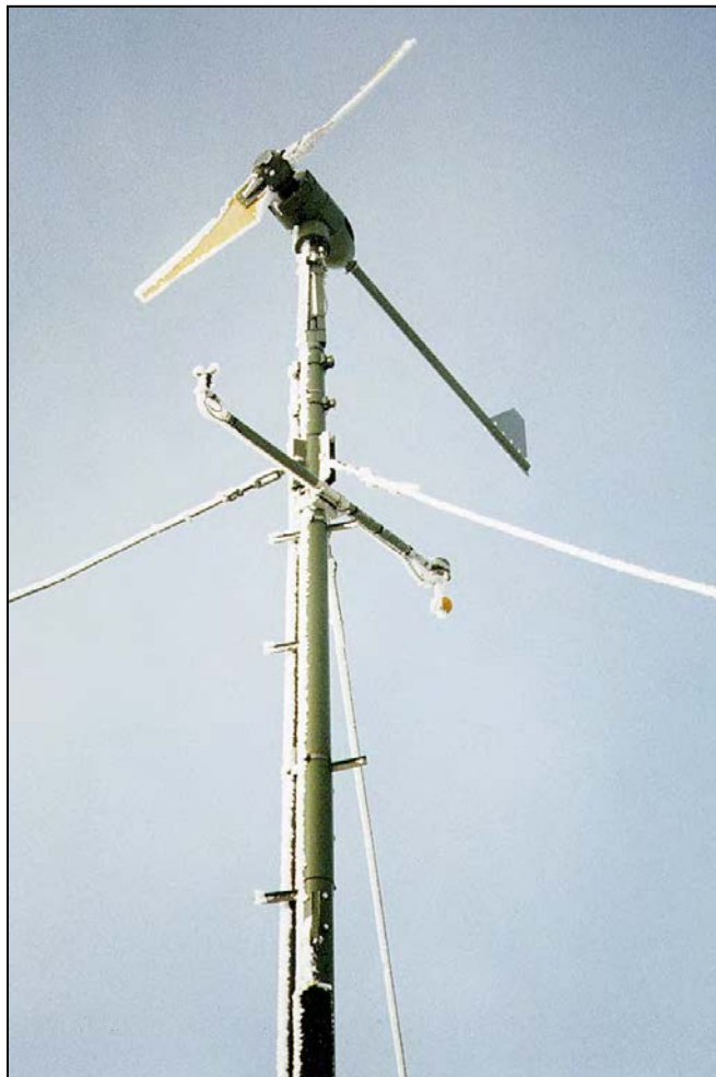
Eolienne du relais HB9G à 1600 m d'altitude. Janvier 1997, température de -20°, l'éolienne est givrée. © Serge NAUDIN, F5SN
