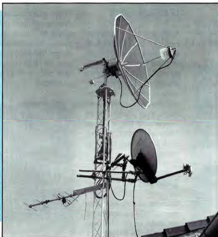
La parabole opérationnelle en site et azimut à 10 m du sol. Noter les petits contrepoids pour soulager et équilibrer le rotor de site.
