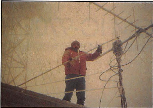
Dimanche 15 à 09h00. F1ONG démonte les antennes en pleine tempête. Remarquer le givre sur les éléments et cables.
