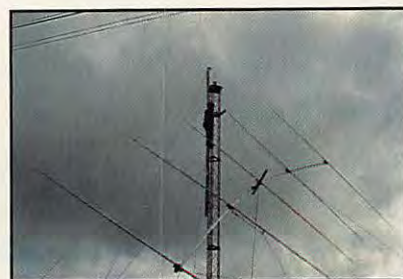
Montage de la Yagi 5 él. 15 m.
