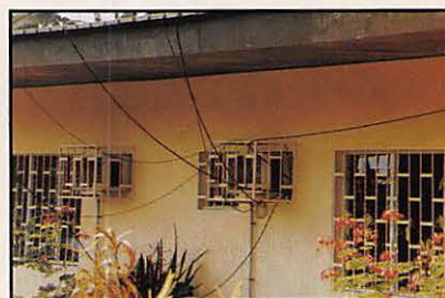
Arrivée des coax par le climatiseur.
