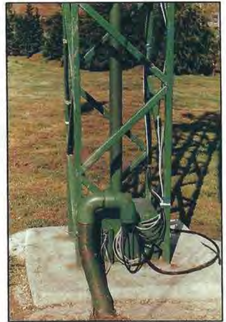
L'ensemble est solidement fixé au sol. Remarquez l'utilisation astucieuse de la tuyauterie PVC et de la gaine électrique.
