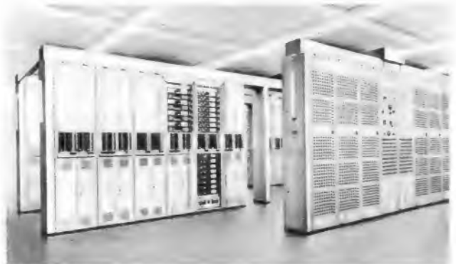
Bild 2. Tonleitungs-Verstärkereinrichtungen mit abgesetzter großer Schaltanlage nach dem Entwicklungsstand von 1954 (Frankfurt a. M.)
