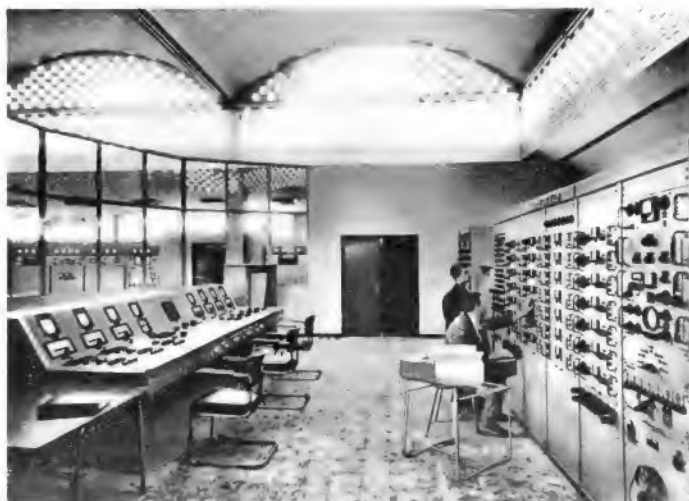
Rechts: Bild 2. Blick in das Gebäude des Senderzentrums El Rosal bei Bogotá. Es liegt in 2700 m Höhe und umfaßt einen 100-kW- und einen 20-kW-Mittelwellensender sowie drei Kurzwellensender mit 50 bzw. 20 kW Leistung. Die Anlage wurde 1961/62 von Telefunken gebaut
