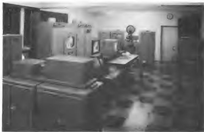
Bild 3. Der Zentralgeräteraum; im Vordergrund links die Farbdi-Anlage, im Hintergrund die Farbfilmabtastanlage, beide von der Fernseh GmbH
