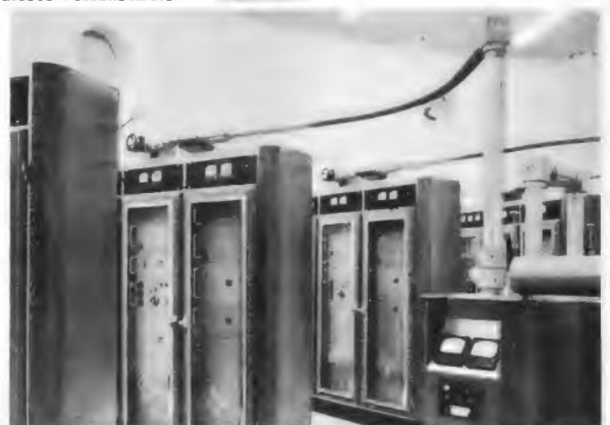
Bild 2. Im Fuß des Johannesburger UKW-Turmes sind sechs 10-kW-UKW-Rundfunksender aufgestellt. Im Bild sind Teile der Senderschänke und der Antennenweiche erkennbar
