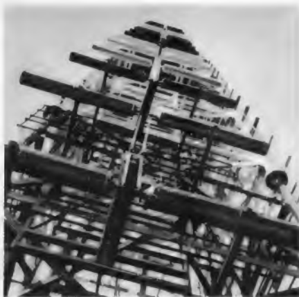
Bild 13. Aus Richtfeldern montierte Rundstrahlantenne auf dem UKW-Turm Johannesburg
