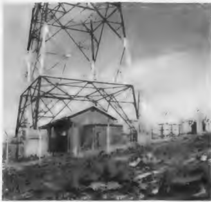
Bild 4. Zweifacher Drahtzaun und eine kapazitive Berührungssperre um Stationsgebäude und Gittermast der unbemannt betriebenen Anlage Rustenburg
