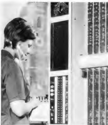
Bild 2. Routinemäßige Überprüfung der Vermittlungsstelle: rechts im Bild der elektronische Markierer, ein Teil der zentralen Steuereinrichtung der Anlage
