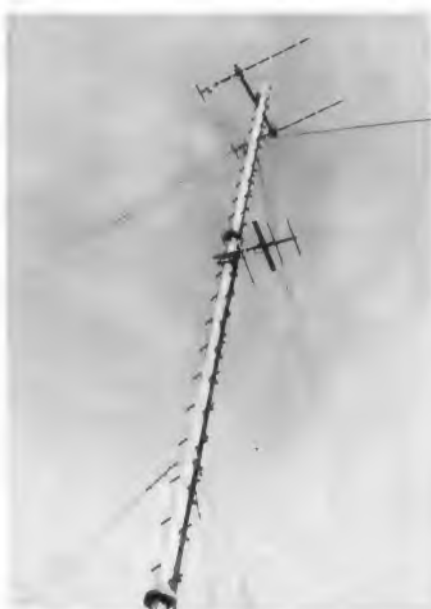
Bild 2. Der Mast des Umsetzers auf dem Oberland. Oben: Zwei Empfangsantennen für Kanal 10 (Vertikal polarisiert). Darunter: Sendeantenne für Kanal 5
