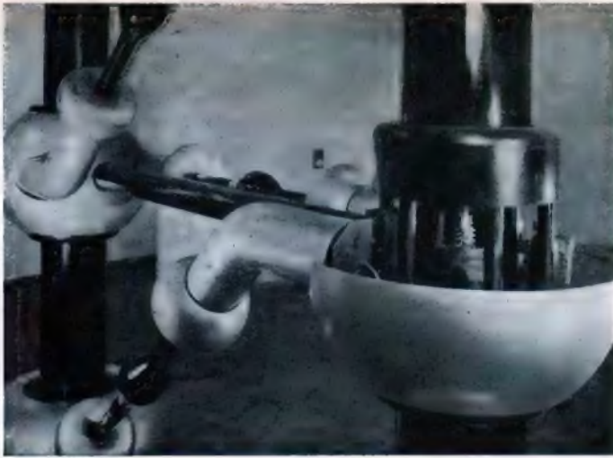
Die Gleichrichterröhren der Hochspannungsanlage müssen natürlich geheizt werden. Da man ihnen die Heizspannung mit Rücksicht auf die hohen Spannungen der einzelnen Ventile gegen Erde nicht gut aus dem Netz oder einer Batterie zuführen kann, sind in den Kugeln zwischen den einzelnen rohrförmigen Kondensatoren besondere kleine Heizmaschinen untergebracht, die über Hartpapierwellen angetrieben werden, die sich im Innern der Rohrkondensatoren drehen. (Werkbilder - 3)
