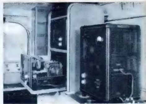
Die wichtigste Ausrüstung des Lautsprecherwagens bilden die Verstärker: Vorn rechts der große 150-Watt-Verstärker, dahinter die kleineren, in einem Gestell herausnehmbar angeordnet.
