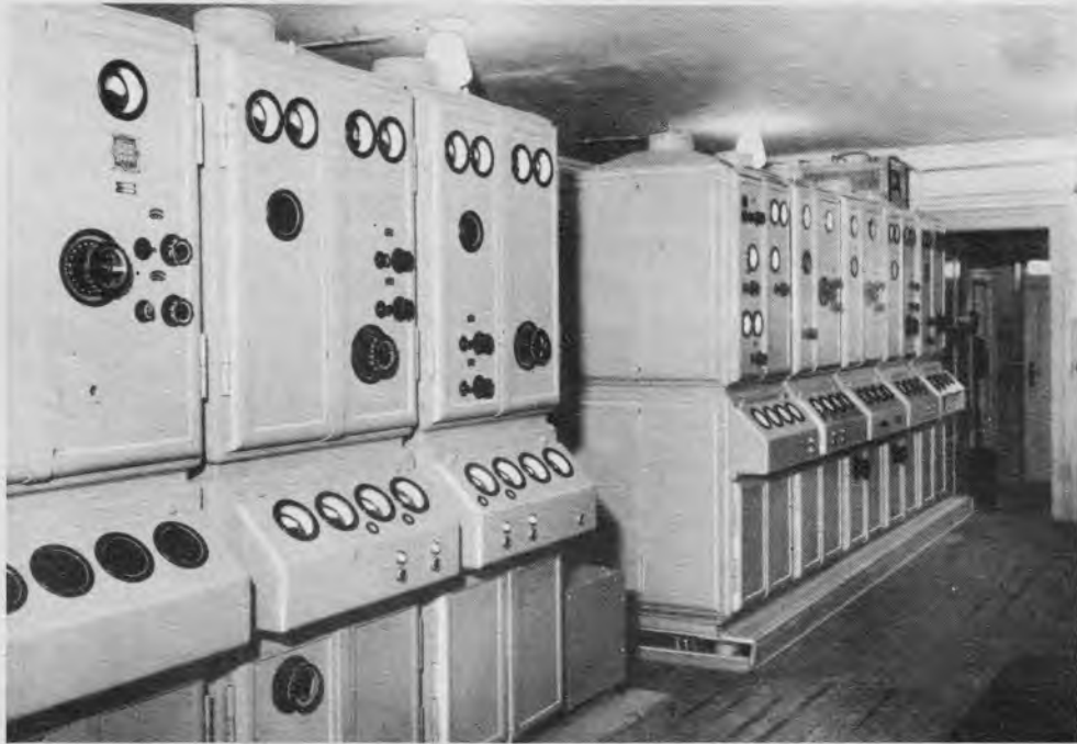
So sieht der neue Fernlehrender aus, der in Berlin-Witzleben Aufstellung gefunden hat. Bildstelle des RPM.
