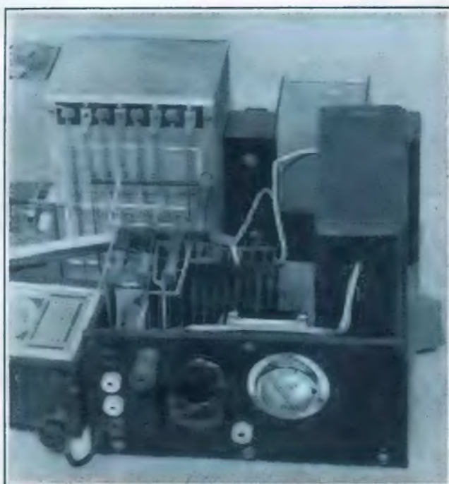
Vorne das Anschlußbrettchen, dahinter das Kuproxsystem, daneben der Trockenelektrolytkondensator, ganz hinten die Netz-drossel und der Kondensatorblock.
