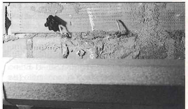
Foto 2 - Interno cassone: sul tubo esagonale si avvolge la tapparella, al di sopra i nodi di fissaggio provvisorio della scaletta.
