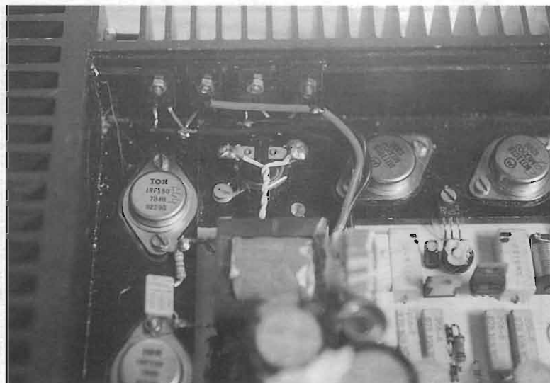
Foto 4 - Particolare dei MOSFET di uno dei due convertitori DC/DC e relativo finale di BF. Al centro della foto il disgiuntore termico ed il ponte di diodi veloci.
